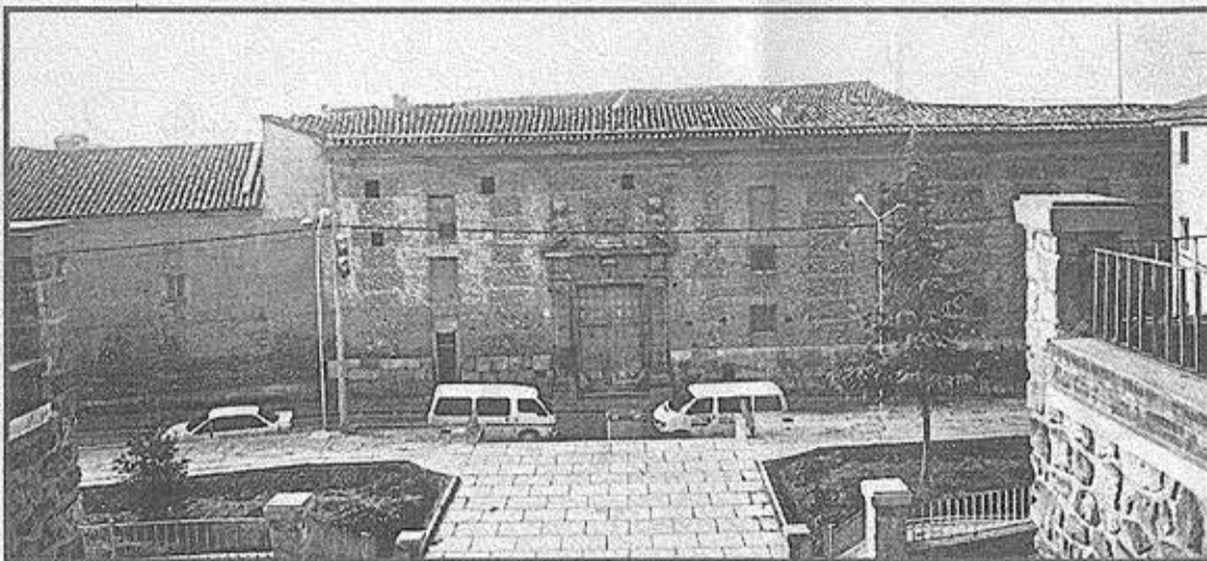
A la izquierda, fachada principal del palacio de los Condes de Aranda en Epila. Debajo, detalle de las grietas de la fachada que da a la calle Palacio Bajo
